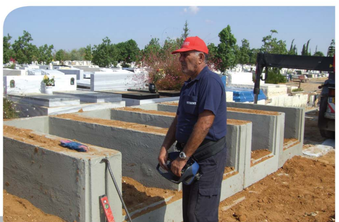
3. הרכבת שורה ראשונה לכל אורכה, על גבי משטח הבטון פילוסה וביצוע איטום תפרים על ידי מסטיק לאיטום מסוג SIKAFLEX.
